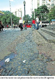
Libre buracos nas calçadas estão na mira dos 20 agentes
